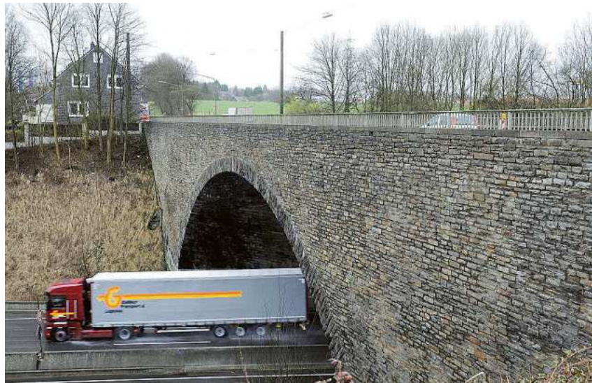
Die Brücke Hüngrer überspannt schon seit vielen Jahrzehnten die Autobahn. Bis sie saniert wird, soll es noch dauern. Archivfoto: Martin Kempner
